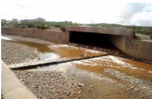
Río Seco en la ciudad de El Alto, con elevada contaminación. Foto MMAA
